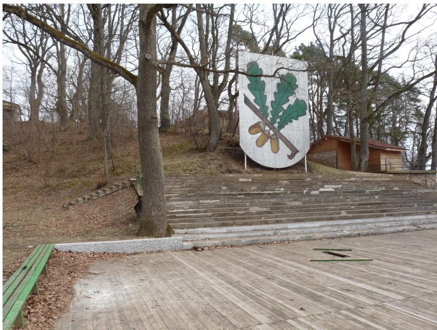
3. attēls. Estrādei izveidoti 18 betona pakāpieni skatuves paaugstinājumam. Betona pakāpieni vietām izdrupuši lietus un mitruma ietekmē.
