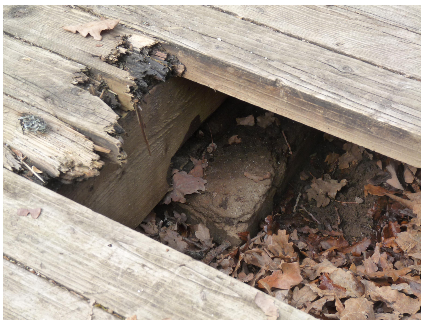
2. attēls. Estrādes grīda veidota uz koka sijām, kas balstītas uz ķieģeļu balstiem. Grīdas koka dēļi daļēji apmierinošā stāvoklī, vietām mitruma ietekmē bojāti.
